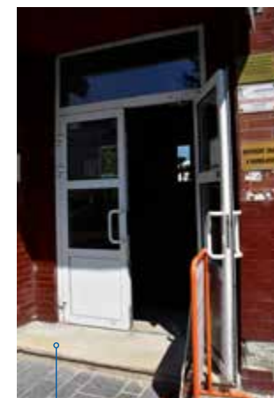
Matrika, Dlhý rad – nevyhovuje, schod do budovy
